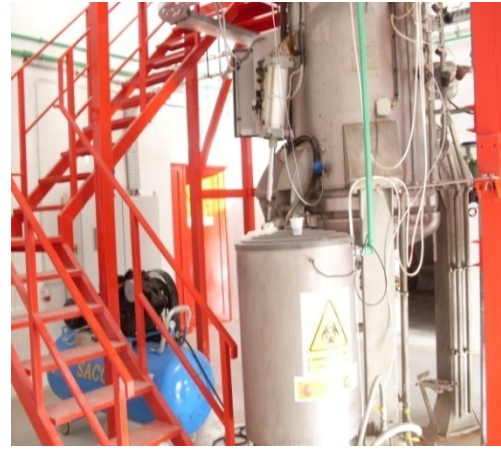
L'autoclave du centre de traitement de Saida
